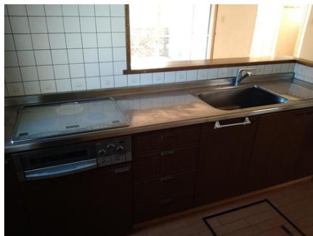
キッチン（IHクッキングヒーター3口）
